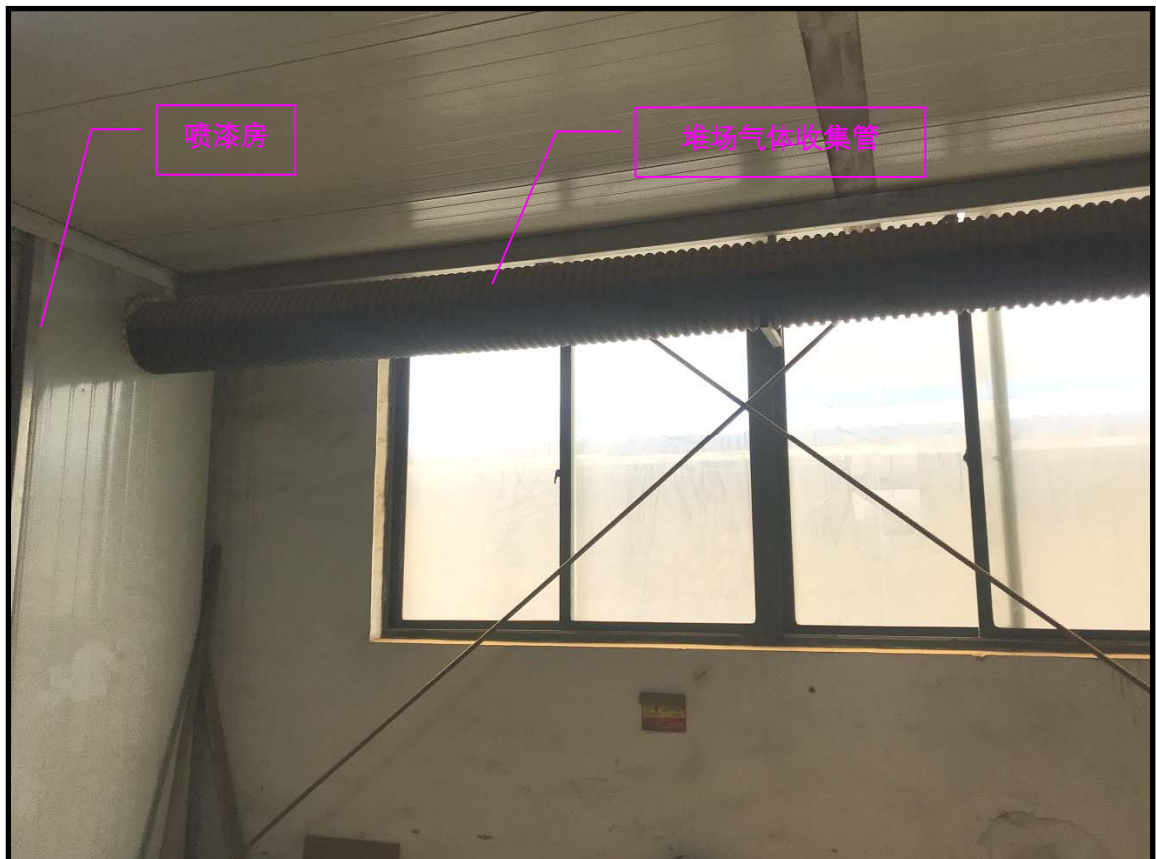
危废堆场地面已做防腐防渗处理，已设置泄漏液体收集池，堆场已设置气体导出口，并接入喷漆工段两级活性炭吸附装置中
