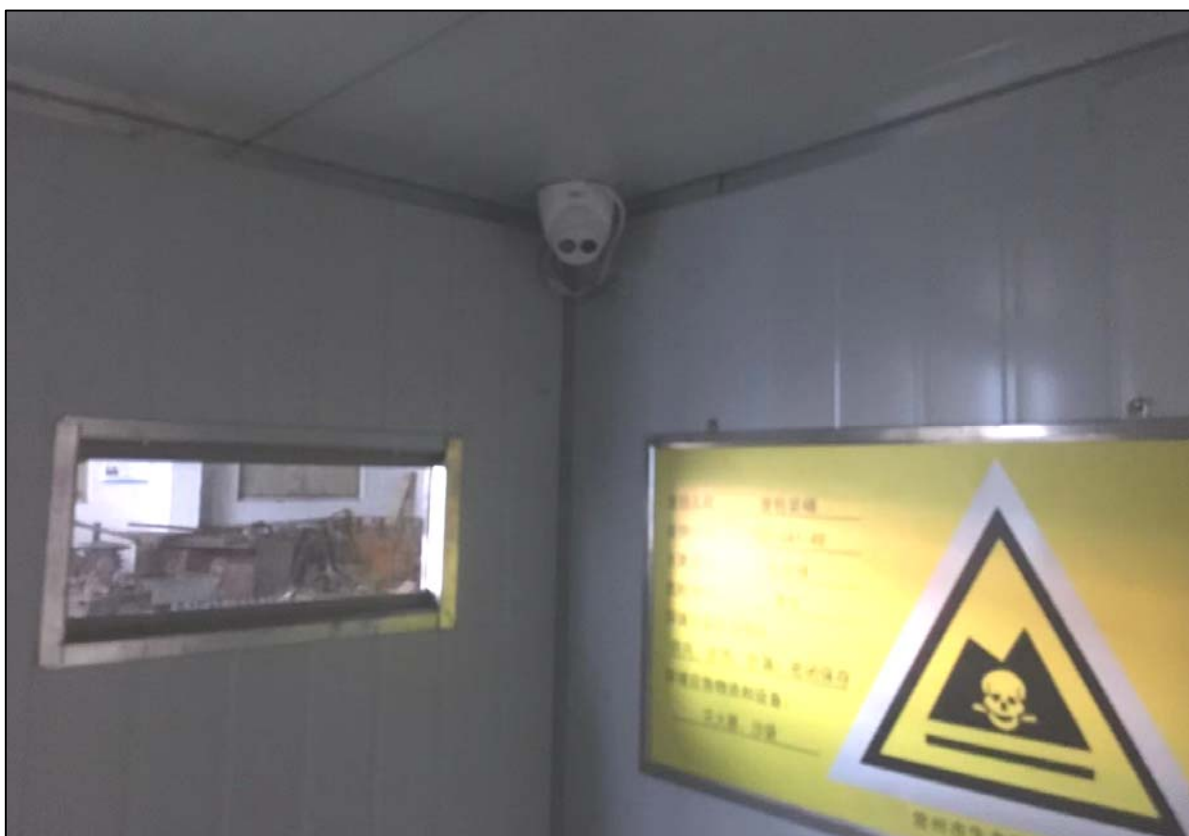
危险废物贮存设施内监控器和观察窗
