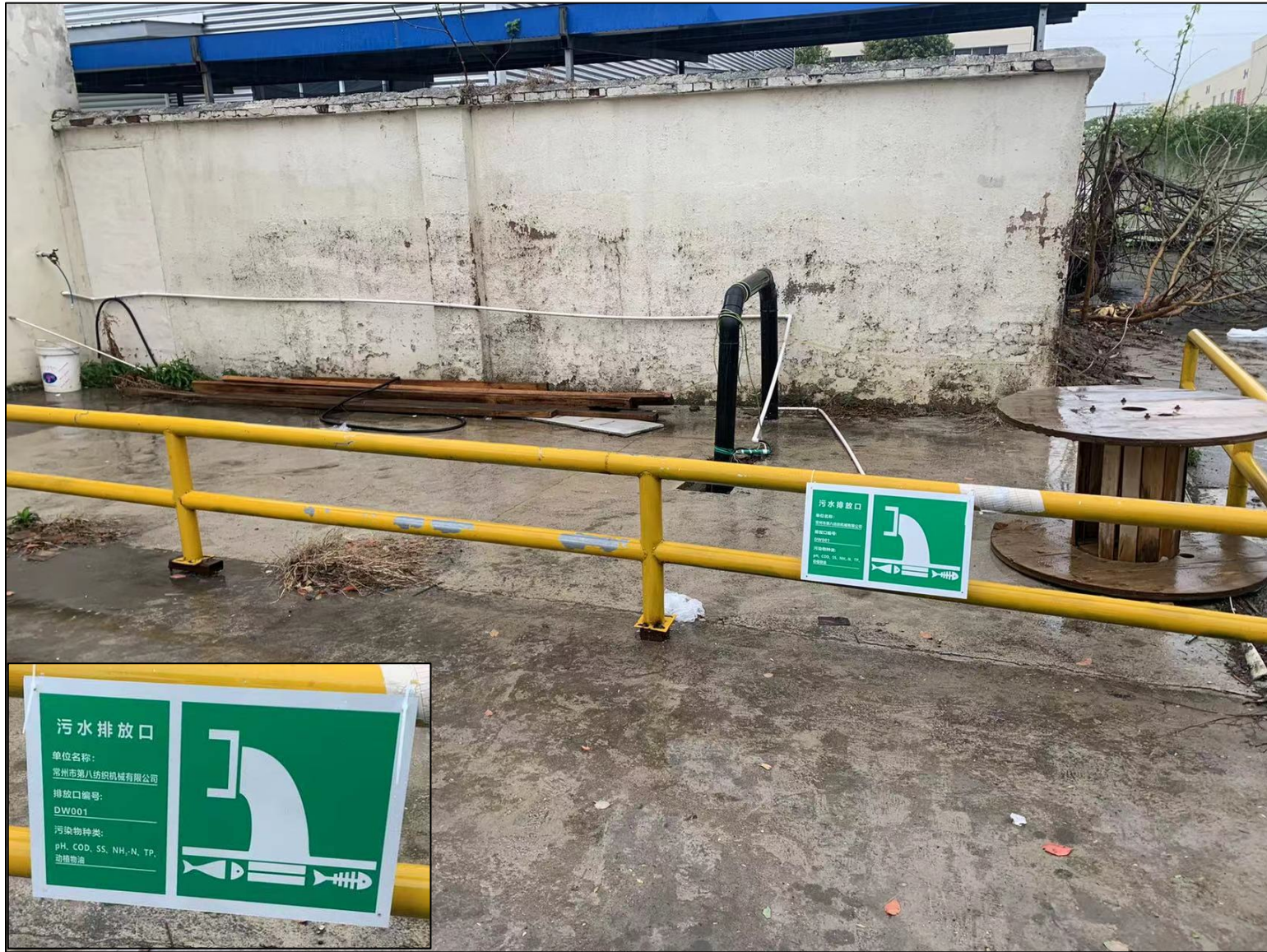
厂区污水提升泵站及环保标识牌
