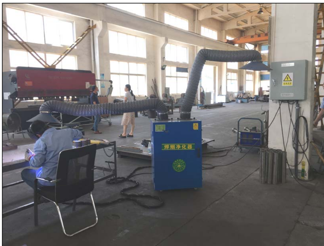
焊接工段移动式除尘装置
