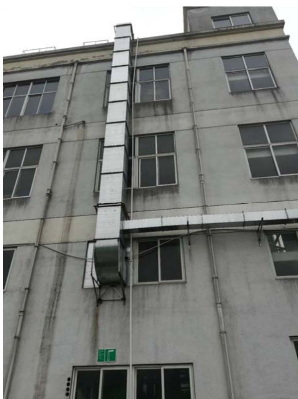
废气排气筒及环保标识牌
