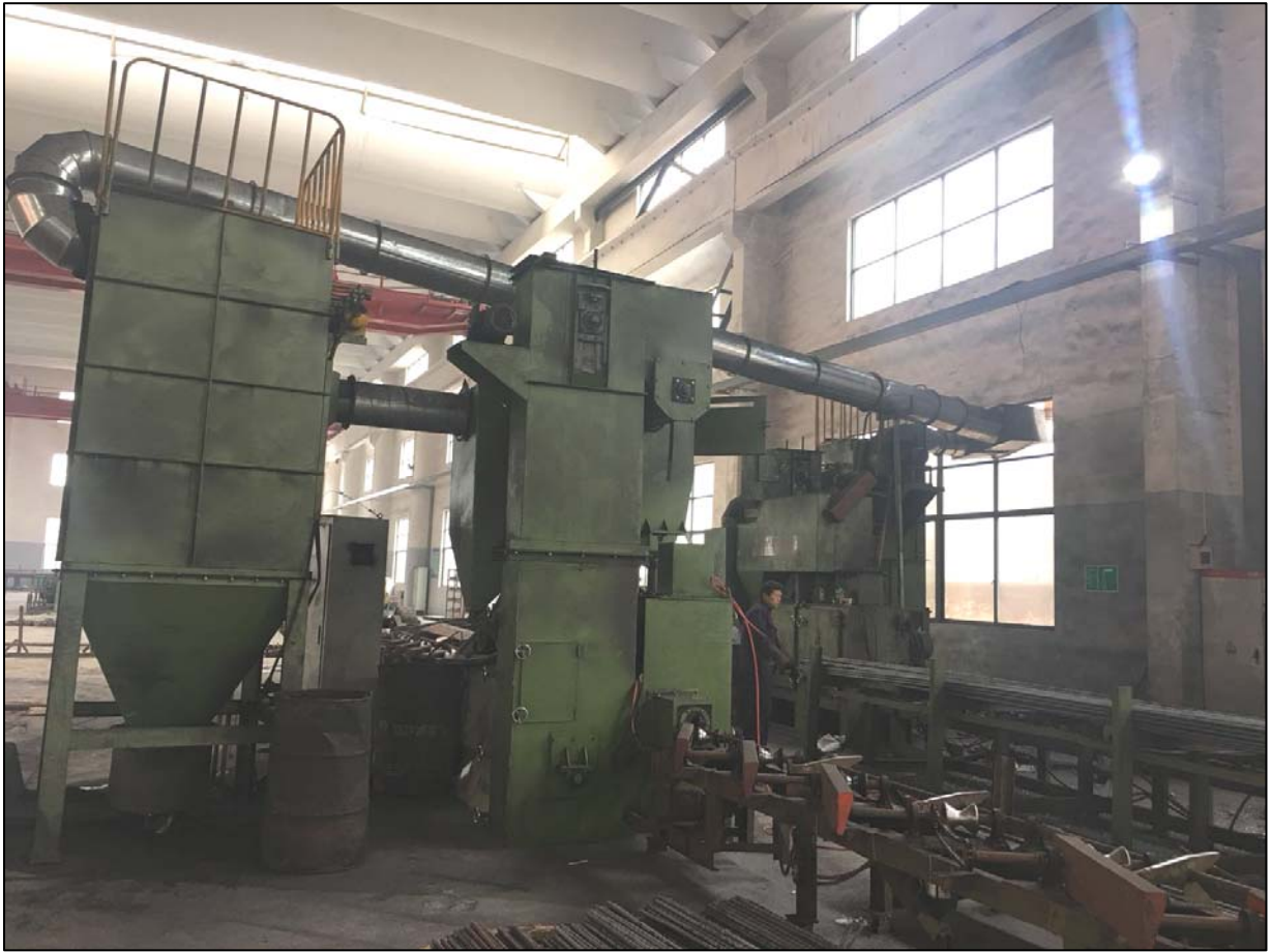
抛丸工段布袋除尘装置和排气筒（FQ-1#）
