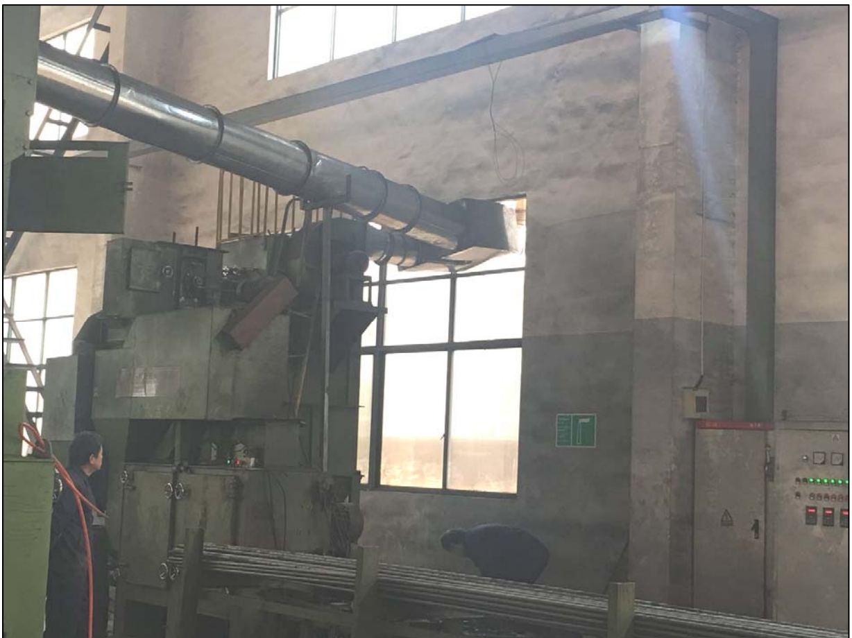
抛丸工段排气筒（FQ-1#）环保标识牌
