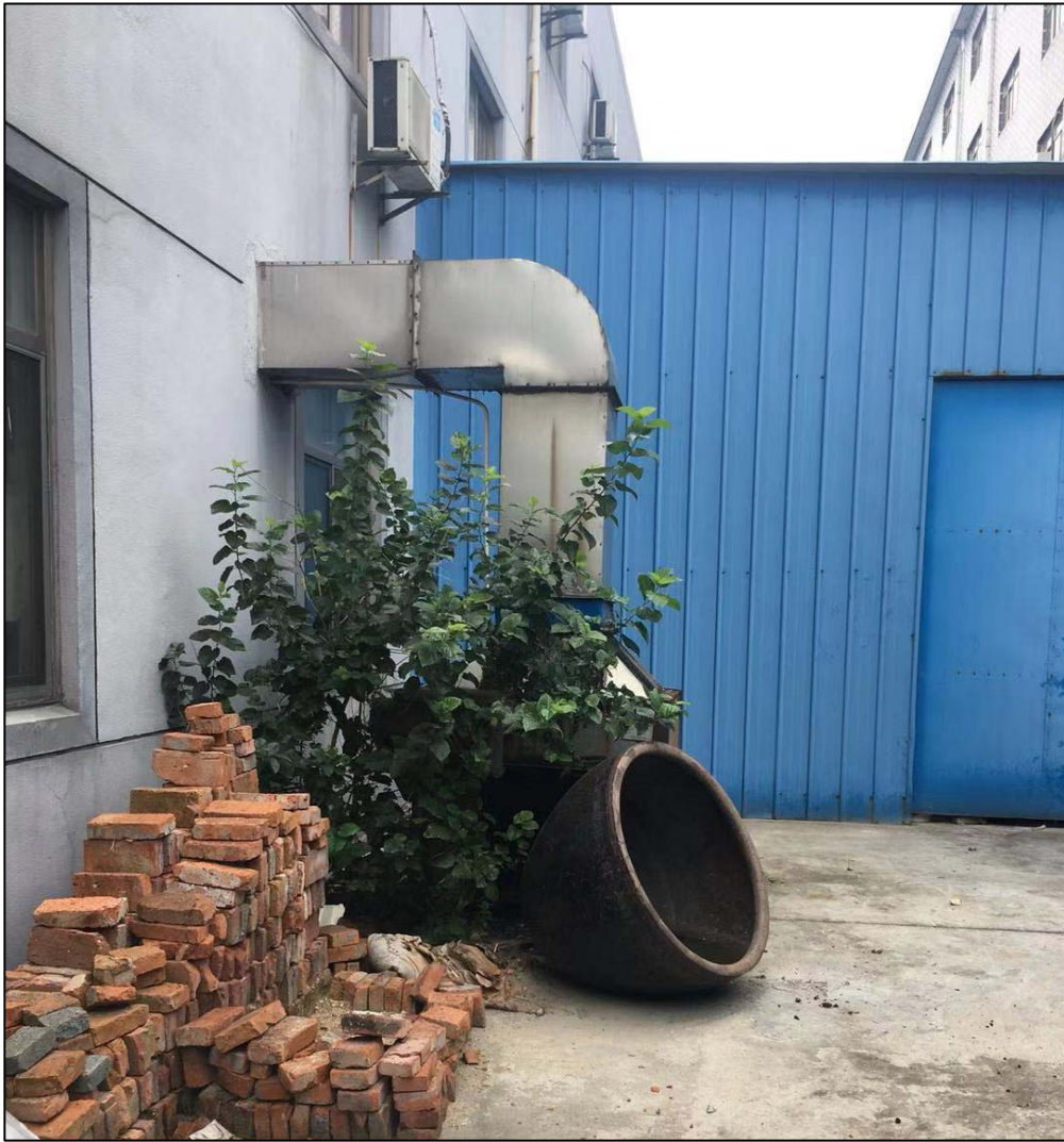
北厂界处食堂油烟净化装置
