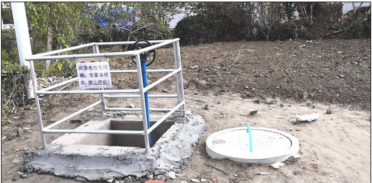
东南厂界处事故应急池、阀门井和切换阀门
