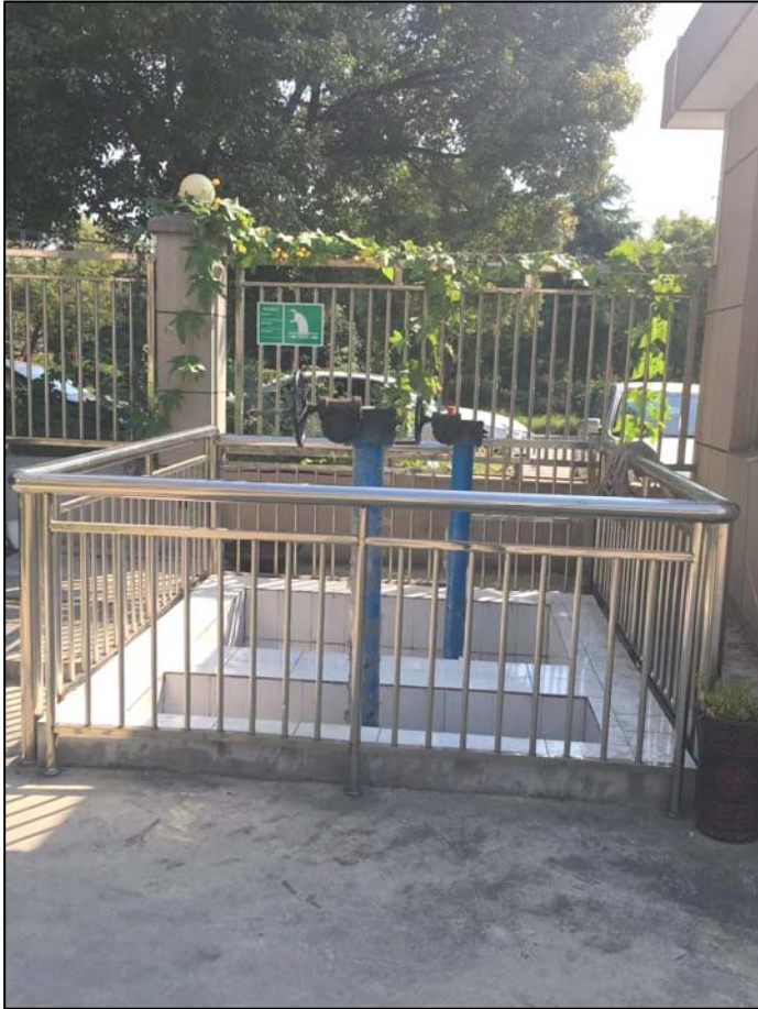
东厂界处初期雨水收集池、 雨水排放口及环保标识牌
