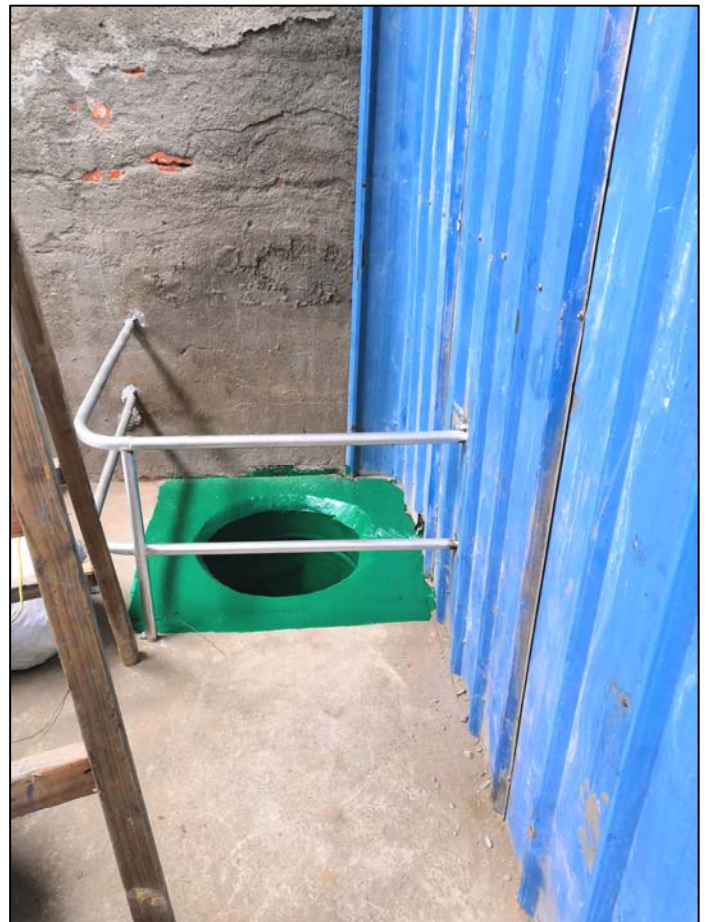
危险废物泄露收集池（地下式）已做防腐防渗处理
