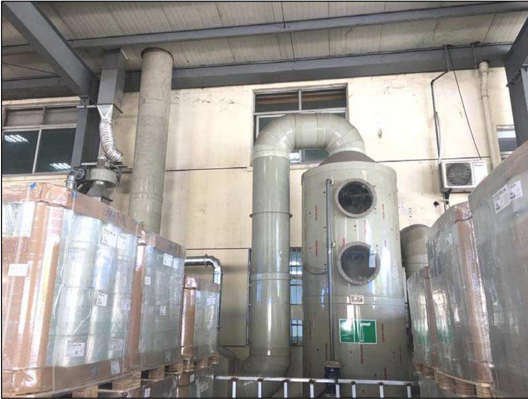
废气处理 装置、排气 筒及环保 标识牌
