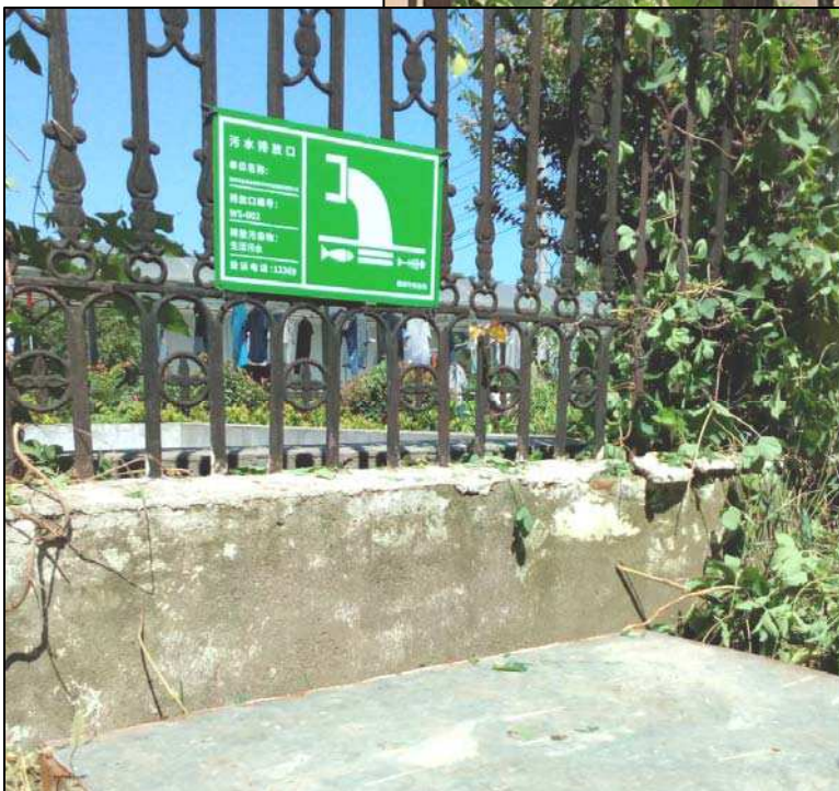
老厂区生活污水排 放口及环保标识牌
