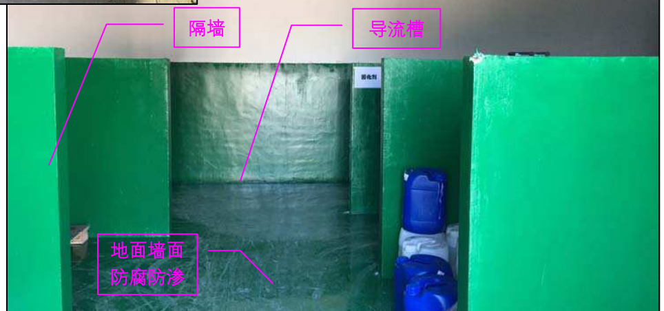
危险废物堆场内分类贮存，地面及墙面处已做防腐防渗，并设有导流槽
