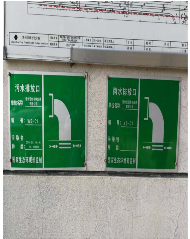
雨、污水排放口
