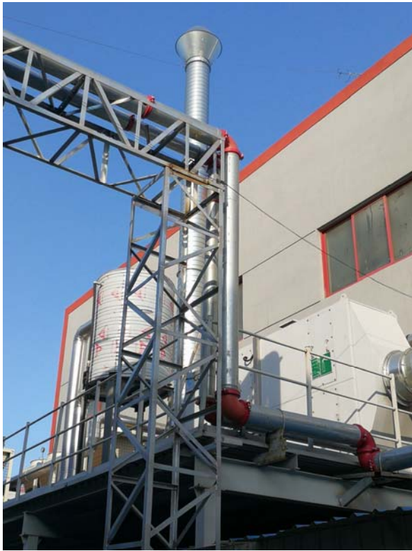
废气治理装置及排气筒
